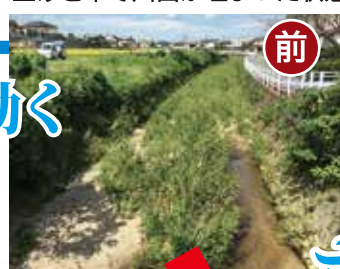
土砂と草で川面が埋まった状態
